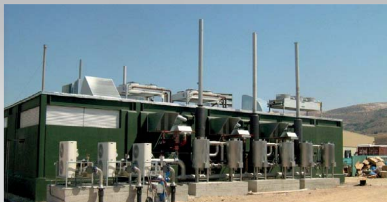
Семь блочных ТЭС с общей мощностью 1,8МВт производят электроэнергию из биогаза.
