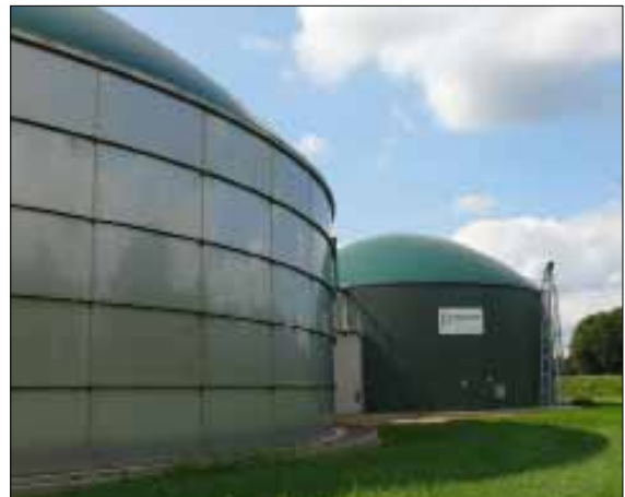
Ab dem Frühsommer 2016 wird der Betreiber den knapp 4.000 Kubikmeter messenden Edelstahl-Fermenter täglich mit 100 Tonnen organischer Reststoffe, 70 Prozent davon sind Schweinegülle, beschicken.
